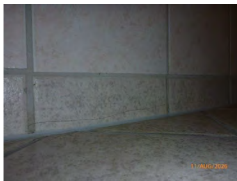
Sprekker i sokkelfiser
