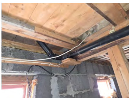
Ufagmessig utførelse av avløpsrør
