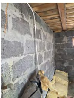
Manglende innfesting av vannrør
