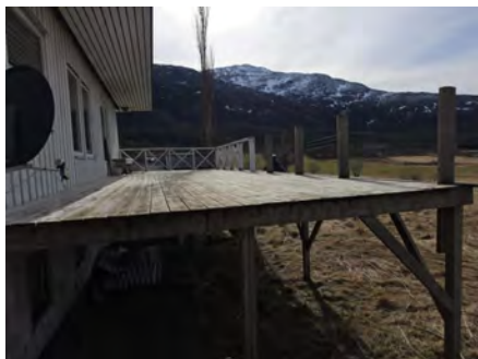
Manglende rekkverk på terrasse
