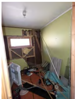
Manglende veggplater på soverom
