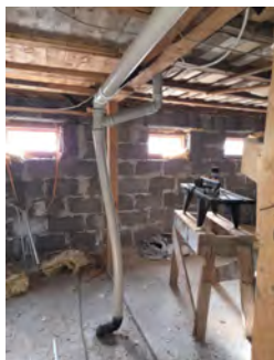
Ufagmessig utførelse av avløpsrør
