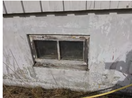
Meget råteskadet vindu i kjellermur
