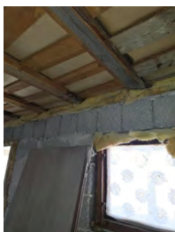
Manglende tetting fra kjeller og inn i bolig
