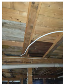
Manglende innfesting av vannrør
