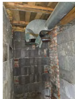
Røykrør er montert i kjeller. Rester etter sentralvarmeanlegg.
