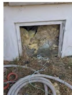
Vindu i kjeller er knust, råteskadet og er montert for nær bakken
