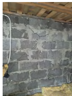
Større riss/sprekk i mur mot bakkenivå
