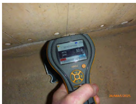
Fukt i treverk med mot gulv. 32%
