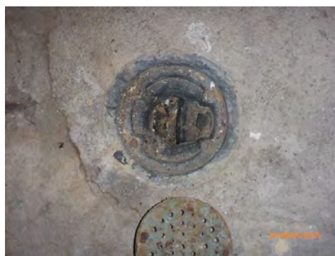
Plastsluk i kjeller
