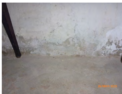
Fuktvandring med saltutslag og avflasket maling.
