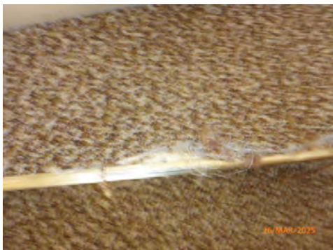
Skade på teppe i trapp
