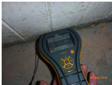
Fukt i treverk med mot gulv. 24,5%
