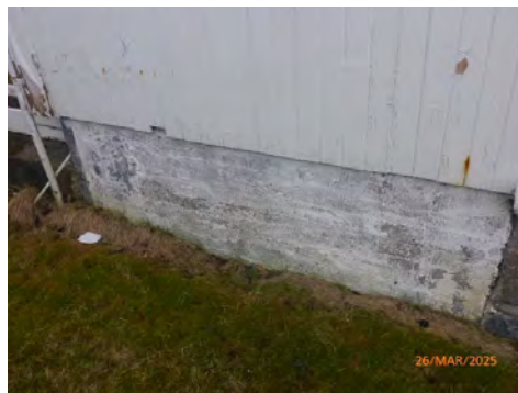
Ingen tettesjikt på mur
