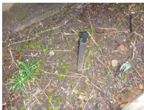
Utvendig stoppekran mot sør.
