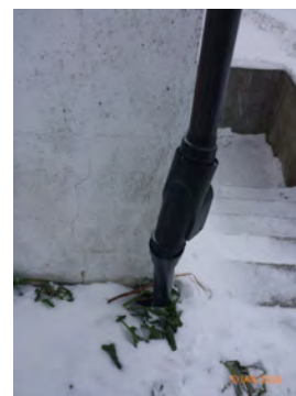
Taknedløp til oppstikkende rør ved mur
