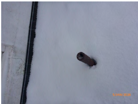
Utv. stoppekran mot øst.
