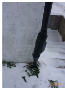
Taknedløp til oppstikkende rør ved mur
