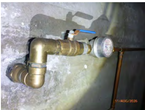
Vanninntak i kjeller
