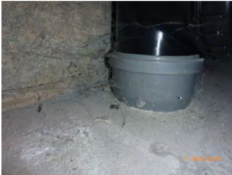
Plastrør opp fra kjellergulv.
