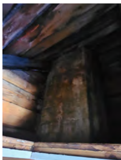
Registrert noe fuktig trevirke i bjelke ved pipe
