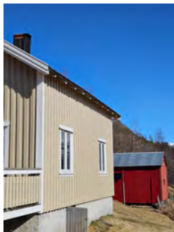
En taksid mangler takrenner og spillblikk.
