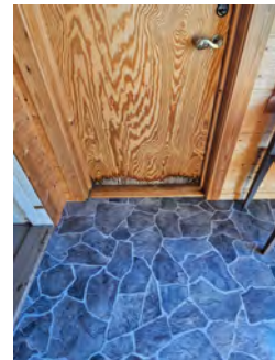
Dør til balkong har noe fuktskader og dårlig tetting nederst.
