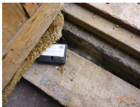
Åtestasjon i kjeller
