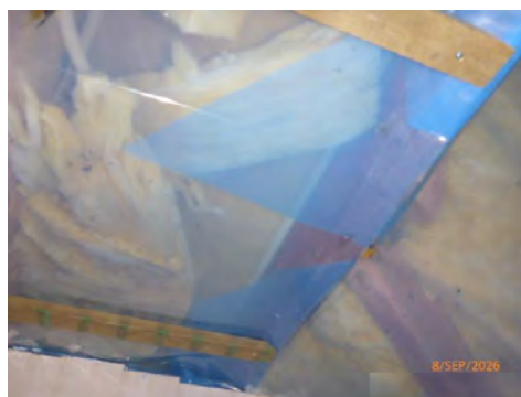
Noe muselort på plast i taket på loft.
