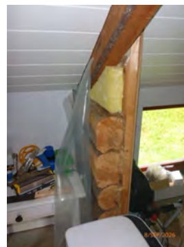
Tømmer på loft med utflyvningshull
