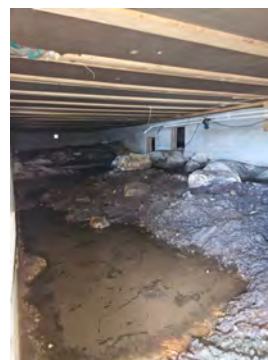
Noe stående vann i krypkjeller
