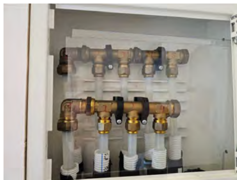
Samleskap montert på bad
