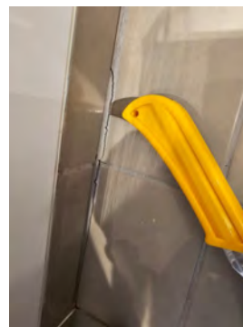
Sprekk i fugemasse mellom gulv og vegg
