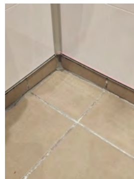
Sprekk i fugemasse mellom gulv og vegg
