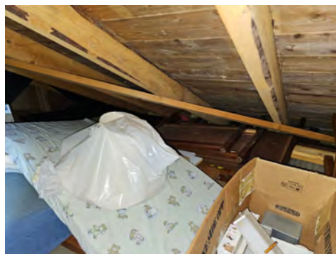
Manglende lufting ved raft
