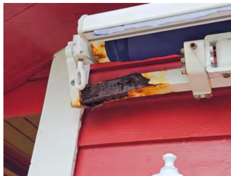
Rustskader på markise
