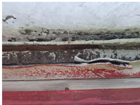
Ikke etablert lufting under kledning.
