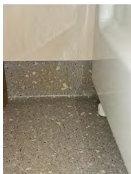
Manglende sokkel list/tetting i bunn av veggplater
