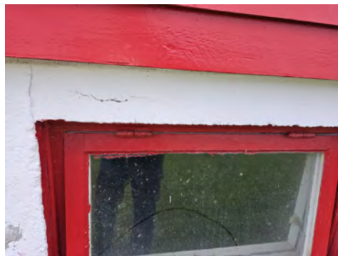
Rustsprengning i mur over vindu
