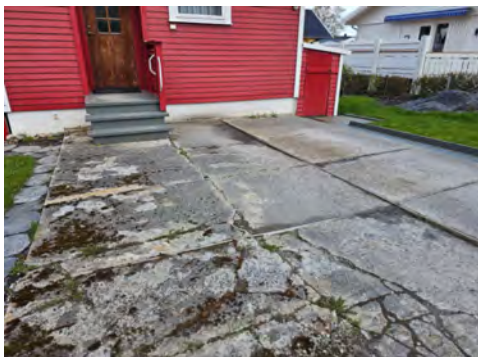
Svakt fall mot grunnmur
