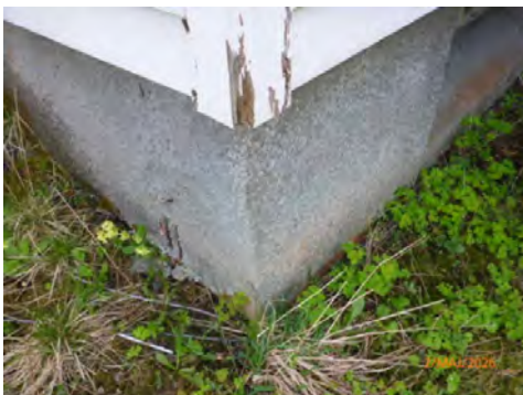
Ingen fuktsikring av mur
