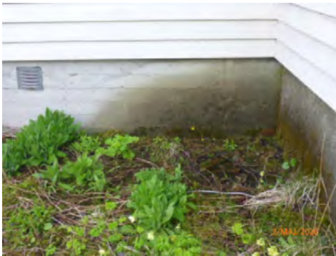
Takvann til terreng ved mur
