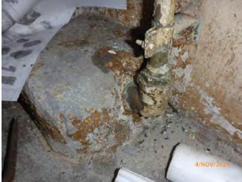
Vanninntaket inne i kjeller
