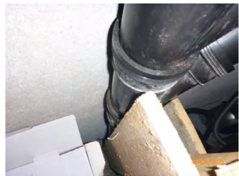
Plastrør i kjeller
