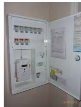
Sikringsskap med kursfortegnelse
