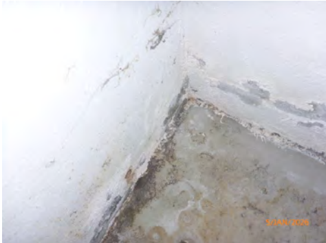
Fuktvandring i underetasjen.
