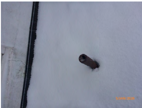
Utv. stoppekran mot øst.
