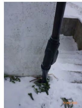
Taknedløp til oppstikkende rør ved mur
