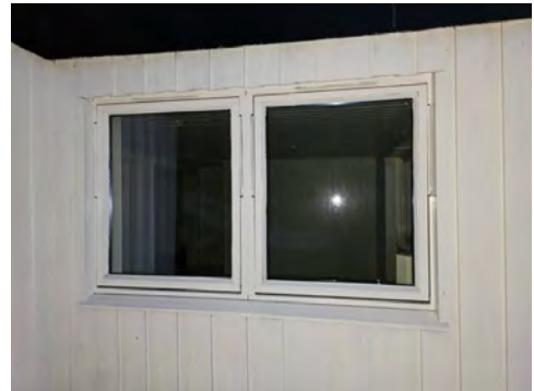
Manglende beslag og vindu
