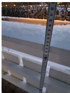
Høyde på rekkverk på ca 82cm
