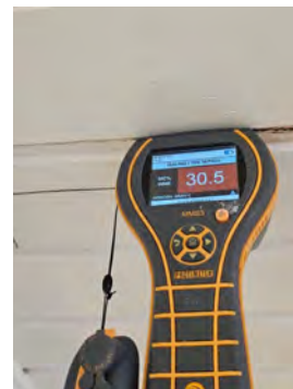
Påvist fukt i himlingspanel i stue
