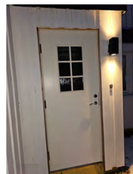
Ytterdør mangler beslag under og over
