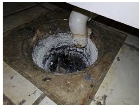
Sluk under dusjkabinett
