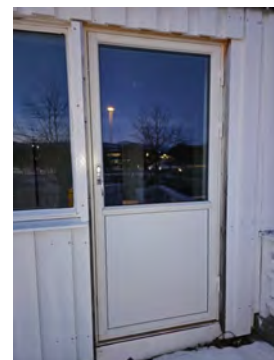
Balkongdør mangler beslag over
