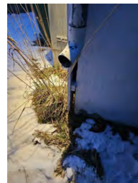
Vann fra nedløpsrør ført til bakken ved grunnmur
