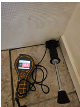
Påvist fukt i utforet vegg på kjøkken.
