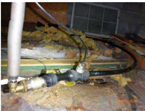
Varmekabel på vannrør
