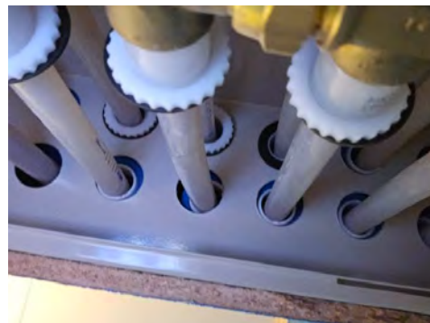
Rørmuffer er ikke festet i skap
