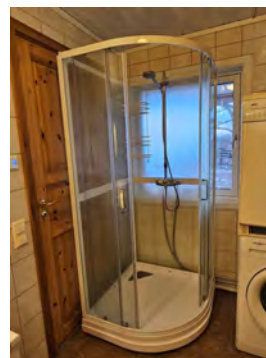
Vindu og dør i våtzone bak dusjkabinett
