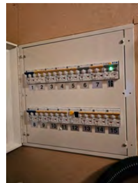
Sikringsskap/underfordeling for hovedplan og loft
