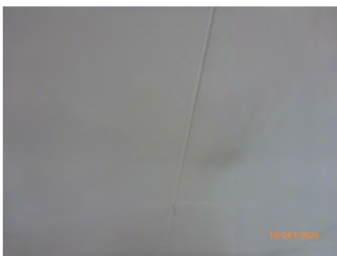
Mørke flekk på himling i 2.et
