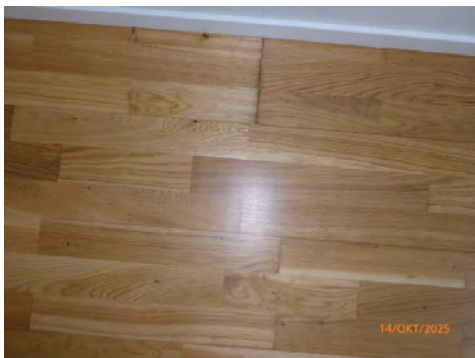
Fuktopptekk i parkett.
