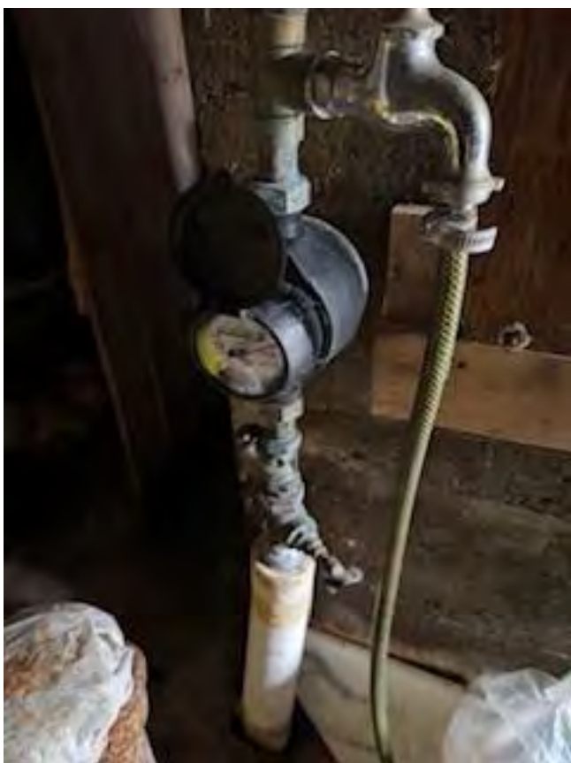
Stoppekran og vannmåler
