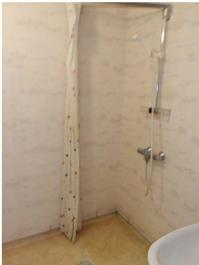
Innredning bad-/vaskerom. Fuktskader på veggteppet ned mot gulvet.
