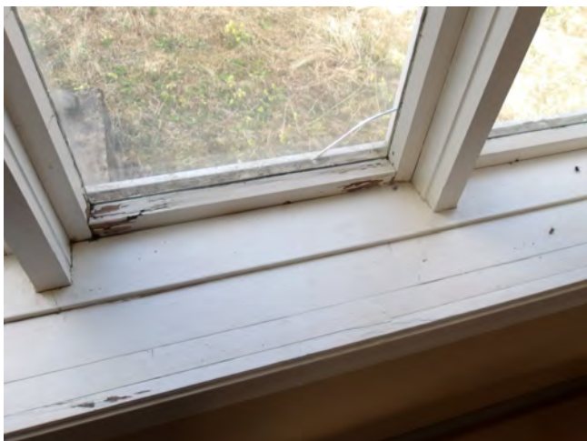
Vinduer med enkle glass har skader.
