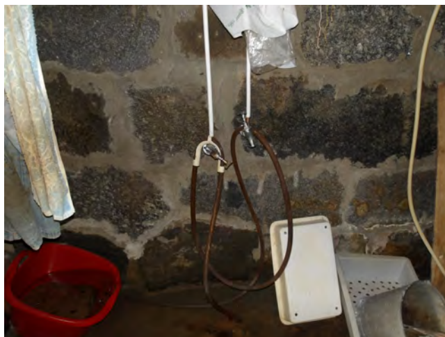
Varmt og kaldt vann i kjeller
