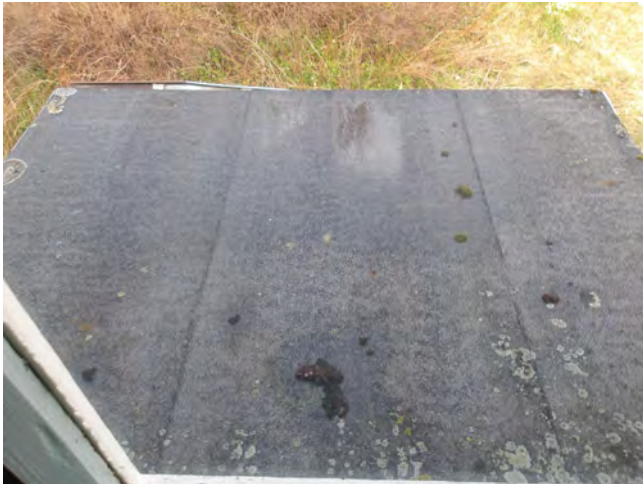
Tak over glassverandaen. Muligens har det vært en balkong.
