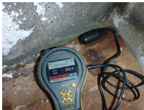
På bod mot nordøst. Vått i sponplater
