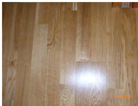
Ved trapp, kul i gulvet
