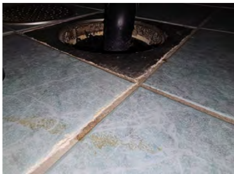
Sluk under dusjkabinett
