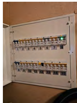
Sikringsskap/underfordeling for hovedplan og loft
