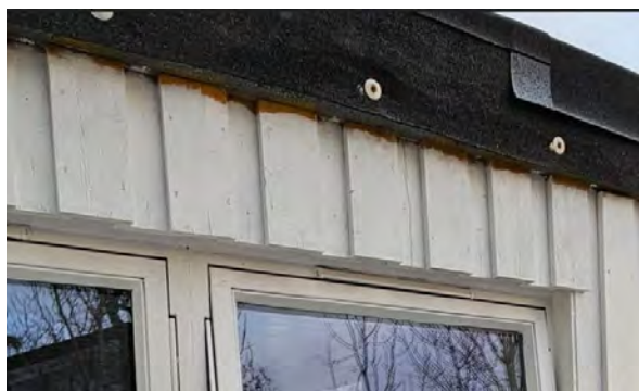
Manglende beslag på papptekking på balkong
