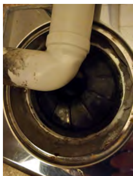
Sluk ved dusjkabinett og vaskemaskin
