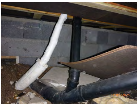
Vann og avløpsrør inn/ut av krypkjeller
