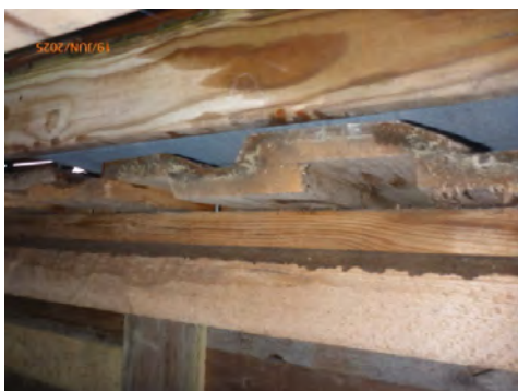
Manglende smådyrsperre under altan mot sørvest.
