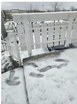
Åpning mellom rekkverk og terrasse er over 10cm
