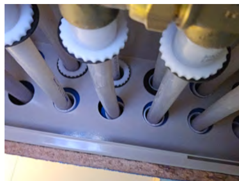
Rørmuffer er ikke festet i skap
