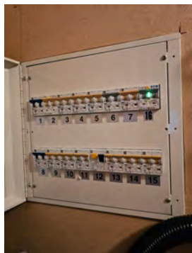
Sikringsskap/underfordeling for hovedplan og loft
