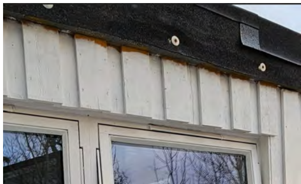
Manglende beslag på papptekking på balkong
