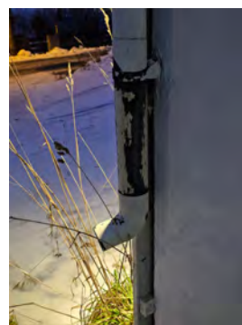
Taknedløp er ikke ført til rør i bakken
