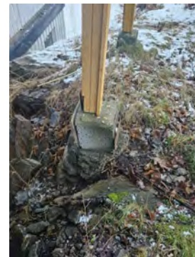
Søyle virker å være dårlig festet i bakken
