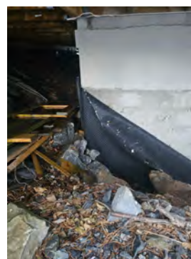
Noe løs grunnmursplast mot sør.
