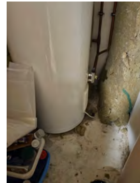
Bereder i eget rom sammen med vannmåler
