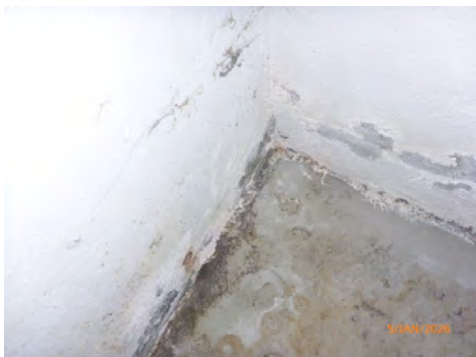
Fuktvandring i underetasjen.
