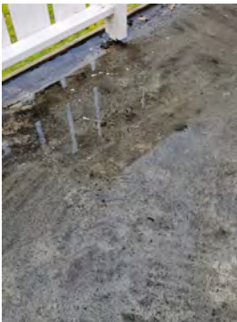
Stående vann på balkong på hovedplan
