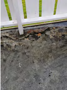
Skader i dekke på balkong hovedplan
