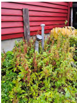
Lufting og påfyllingsrør til oljetank
