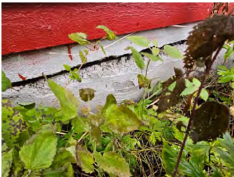
Synlig armering på kjellermur
