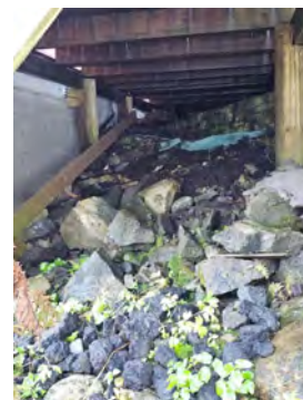
Terrenget faller inn mot murer på bygget
