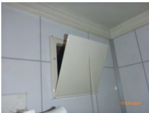
Ventil i yttervegg
