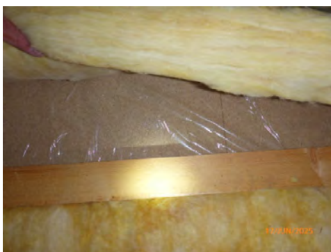
Synlig dampsperre mot varm side
