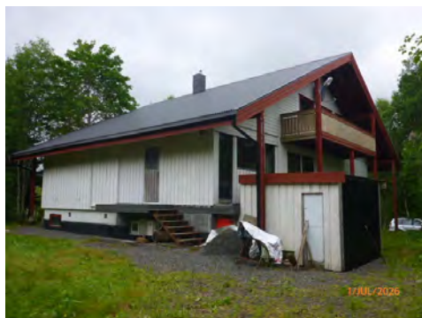
Ikke fall på terreng fra murer
